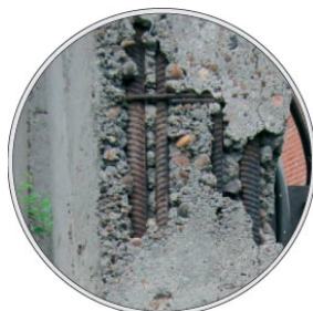
Прочность соединения внахлест зависит от прочности бетона и разрушение защитного слоя бетона конструкции часто приводит к преждевременному его отказу
